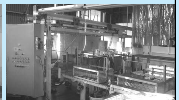
▲環境対応型洗浄装置
